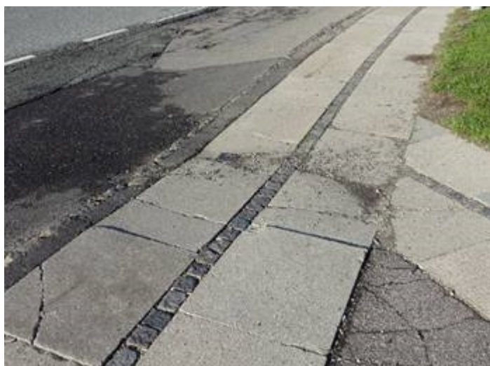
Foto 3: Eksempel på skadespoint 3 (Vallensbækvej – strækning fra Vallensbæk Torvevej til Brøndby)
