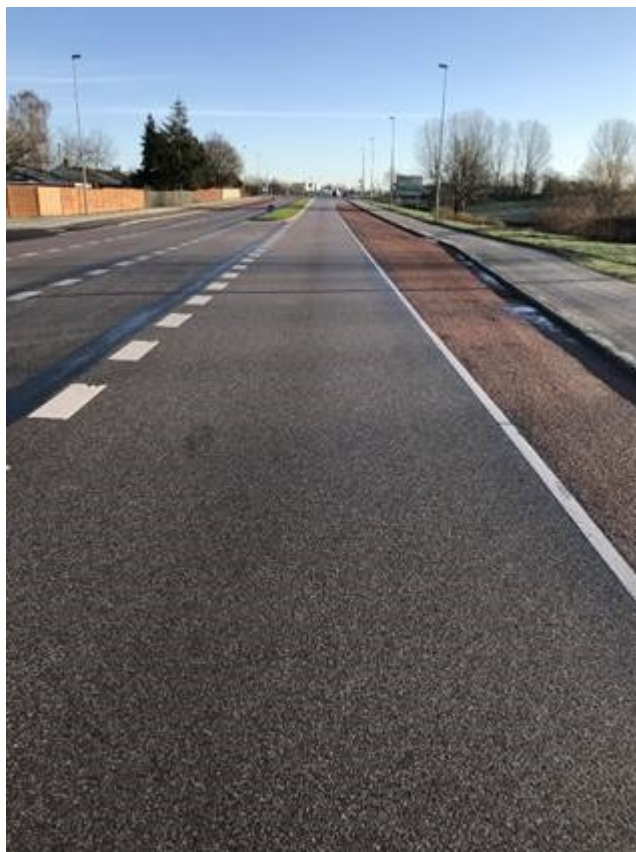
Foto 1: Eksempel på skadespoint 1 - Vallensbækvej
