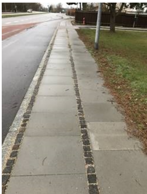
Foto 1: Eksempel på skadespoint 1 (Vallensbækvej)
