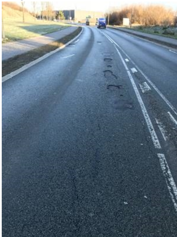
Foto 4: Eksempel på skadespoint 4 - Vallensbæk Torvevej (fra kommunegrænsen ved Albertslund til Vallensbækvej)
