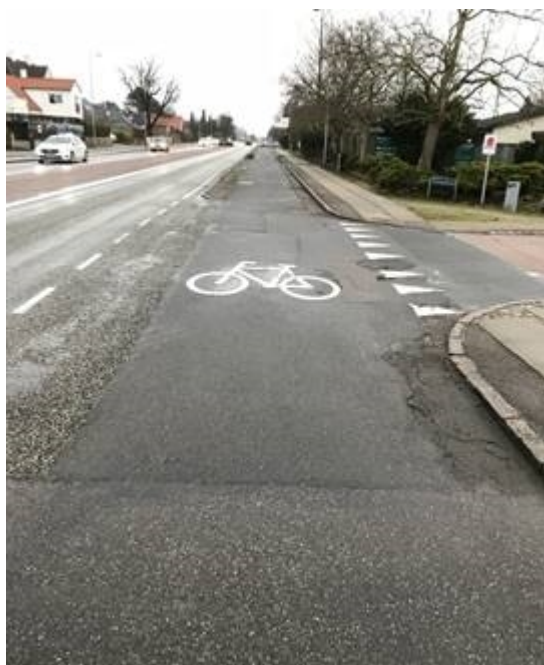
Foto 3: Eksempel på skadespoint 3 (Vallensbæk Strandvej – sydvestlig strækning)
