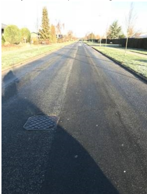
Foto 2: Eksempel på skadespoint 2 - Syvbjergvej
