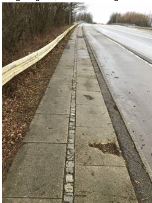
Foto 4: Eksempel på skadespoint 4 (Vejlegårdsvej)
