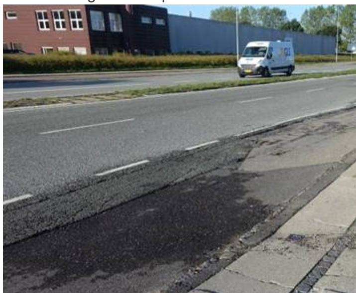
Foto 4: Eksempel på skadespoint 4 (Vallensbækvej fra Vallensbæk Torvevej til Brøndby)
