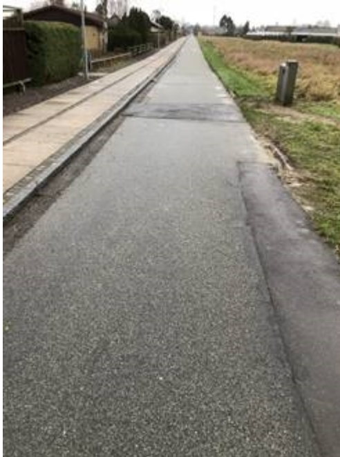
Foto 2: Eksempel på skadespoint 2 (Pilestien)
